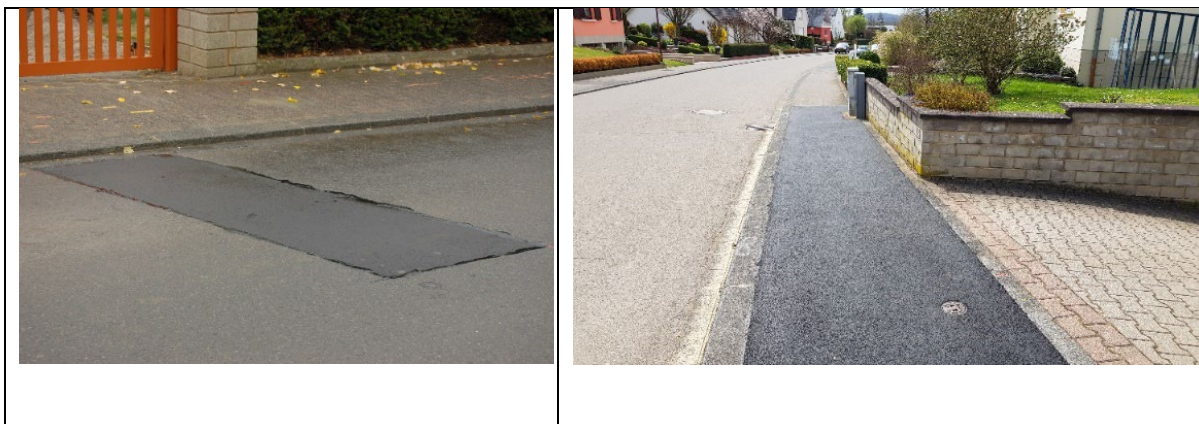
Exemples de réfections appropriés
